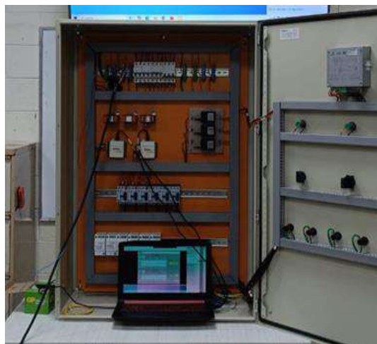
Sistema didáctico de control automático para corrección del factor de potencia.
