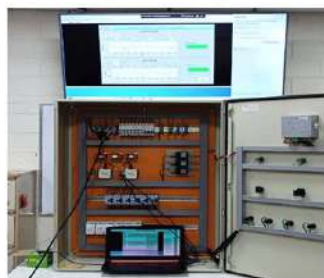
Fig. 2: Tablero de Control.
