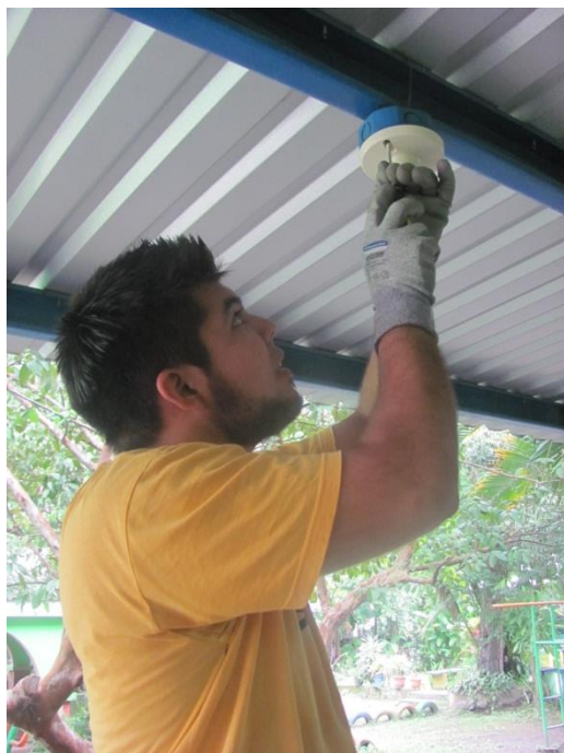
Estudiante voluntario instalando un receptáculo en condiciones seguras y bajo norma.
