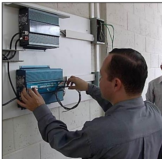
Instalación de inversores en el laboratorio experimental de energías renovables.
