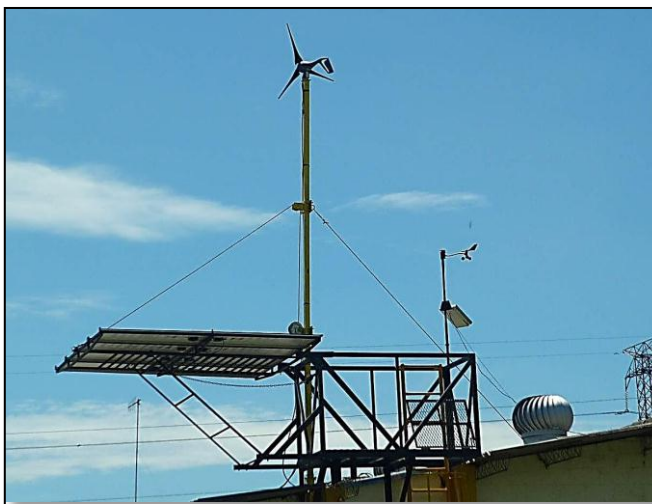
Sistema híbrido de paneles solares, aerogenerador y estación meteorológica instalados para prueba piloto en la Sede Central, Santa Tecla.
