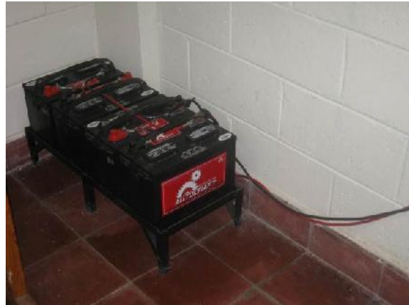
Fig. 21. Banco de baterías
