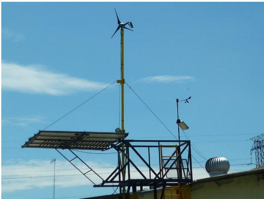
Fig. 26. Vista de los paneles fotovoltaicos y aerogenerador
