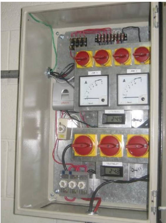
Fig. 22. Panel de Control
